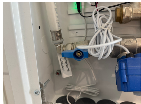
Stoppekran i rør i rør skap.
