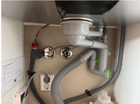
Røropplegg og aquastop under vask.
