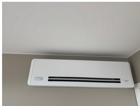
Viftekonvektor i stue/kjøkken.
