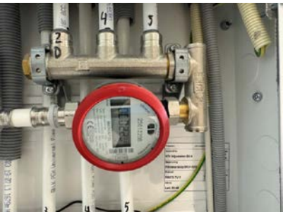
Forbruksmåler i rør i rør skap.
