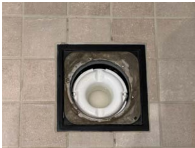
Plastsluk i dusjsone.
