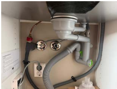
Røropplegg og aquastop under vask.
