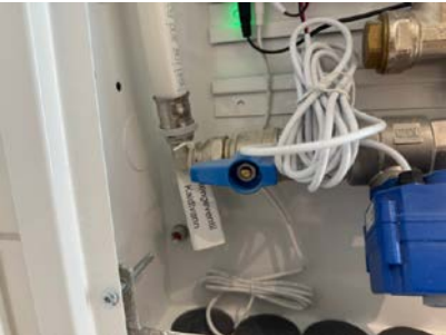
Stoppekran i rør i rør skap.
