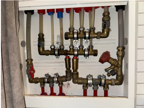
Rørskap på badet med stoppekraner.
