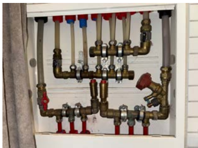
Rørskap på badet med stoppekraner.
