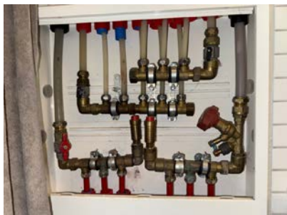
Rørskap på badet med stoppekraner.
