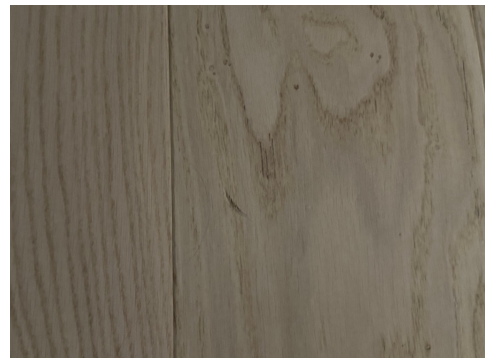
Hakk i parkett i stue/kjøkken. Må anses å være normal slitasje.
