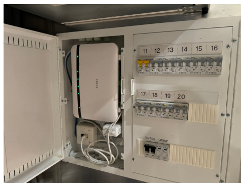
Sikringsskap i teknisk kott.
