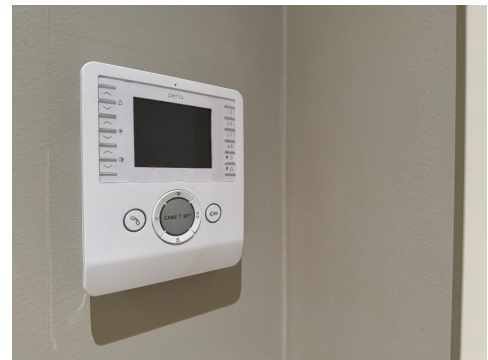
Dørtelefon i entre/gang.
