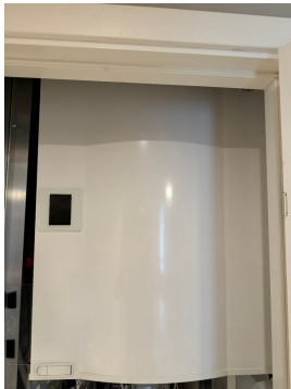
Luftbehandlingsaggregat i teknisk kott.
