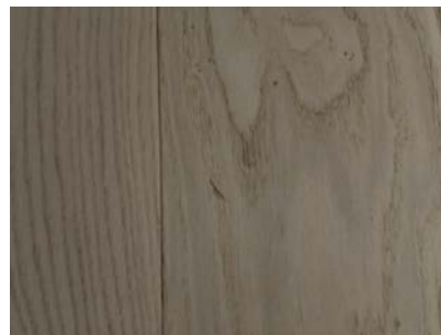
Hakk i parkett i stue/kjøkken. Må anses å være normal slitasje.
