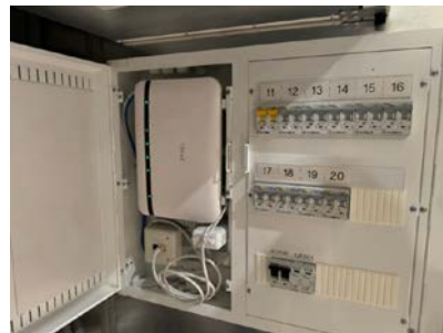
Sikringsskap i teknisk kott.
