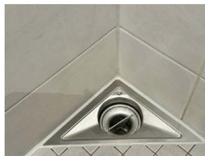
Stålsluk i dusjsone.
