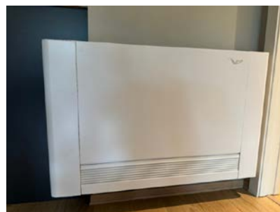
Viftekonvektor i stue/kjøkken.
