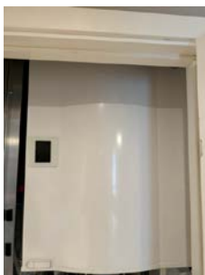
Luftbehandlingsaggregat i teknisk kott.
