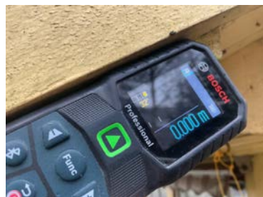
Krav til snøfangere med tak over 27 grader. Dette taket har 32 grader.
