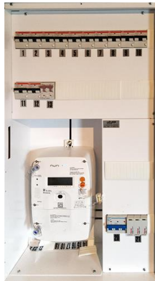
Elektrisk anlegg - [sikringsskap]
