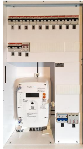
Elektrisk anlegg - [sikringsskap]
