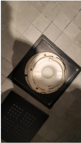
Våtrom - [sluk bad]
