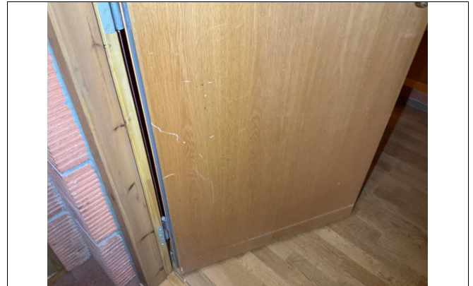
Bruksslitasje på entredør.
