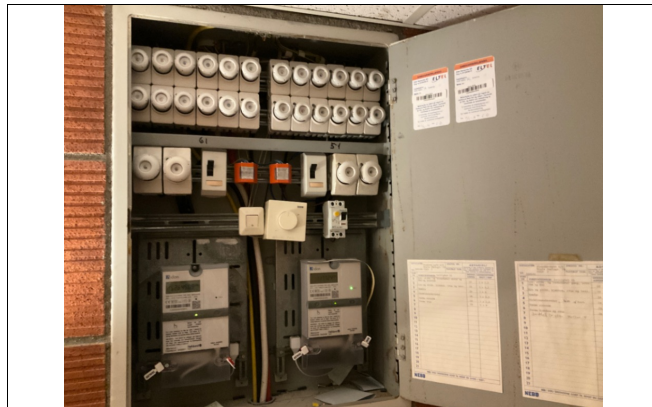
Sikringskap med originale skrusikringer.
