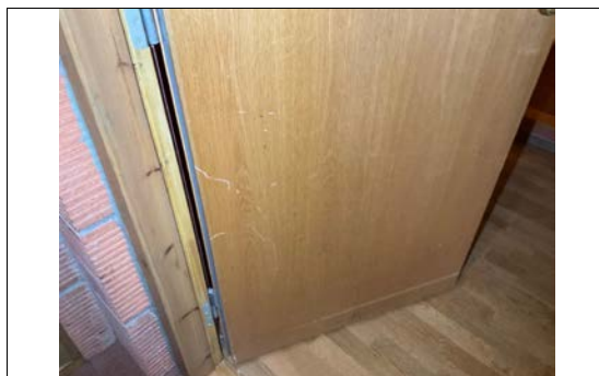
Bruksslitasje på entredør.
