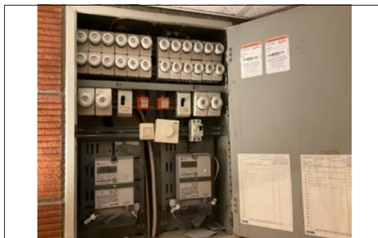
Sikringskap med originale skrusikringer.
