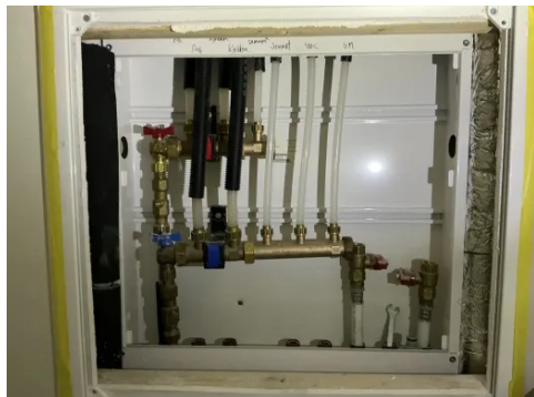
Fordelerskap plassert på bod.
