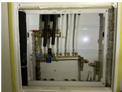
Fordelerskap plassert på bod.
