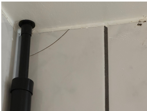
Sprekk i veggflis i øvre del av dusjsone.
