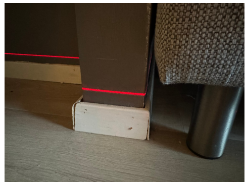
Bilder viser skjevheter i gulv i stue/kjøkken.
