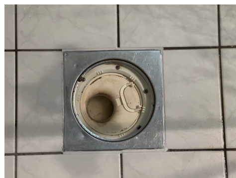
Plastsluk i dusjsone.
