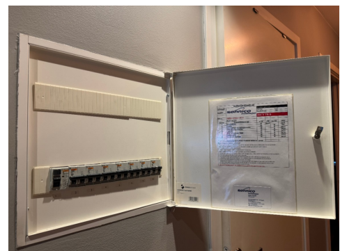
Sikringsskap i gang.
