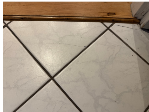
Sprekker i gulvfliser v/ dør (utenfor dusjsone).
