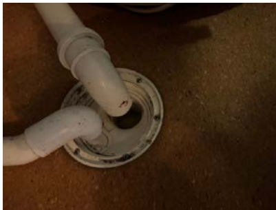
Plastsluk i gulv. 1-ETG > VASKEROM (3,5 M²)
