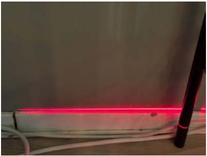
Bilder viser skjevheter i gulv i stue/kjøkken.
