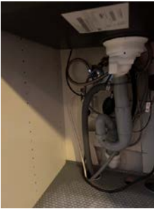
Røropplegg under vask. 1-ETG > STUE/KJØKKEN (35 M²)
