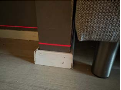
Bilder viser skjevheter i gulv i stue/kjøkken.
