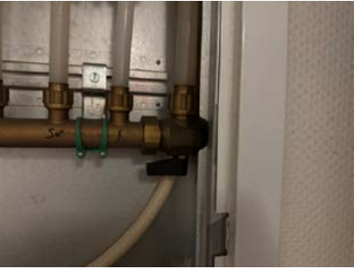
Stoppekran i rør i rør skap.
