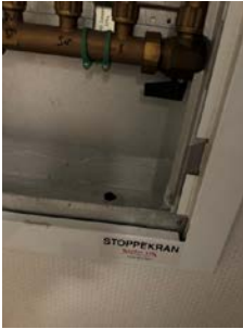
Membran i bunn i rør i rør skap. Avløpsrør
