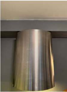
Kjøkkenventilator. TEKNISKE INSTALLASJONER
