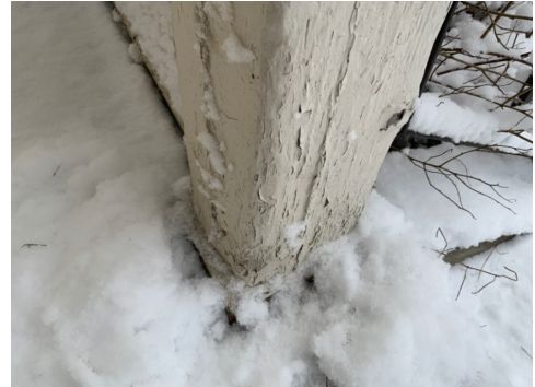
Råteskader i søyler.
