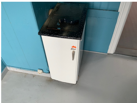
Mangler platte på gulv foran ovn og ovn er plassert for nær treverk og pipe
