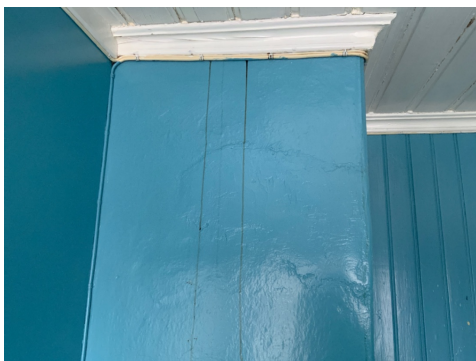
Rennemerker på pipe.
