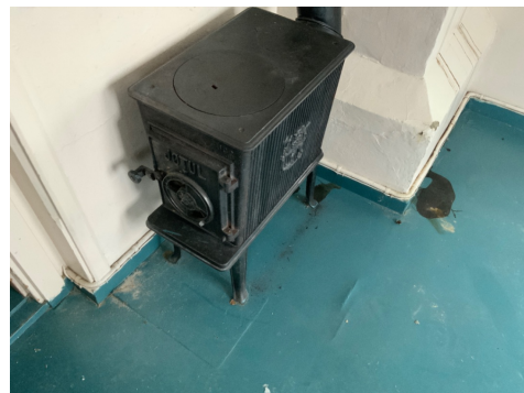
Mangler ildfast plate foran ovn
