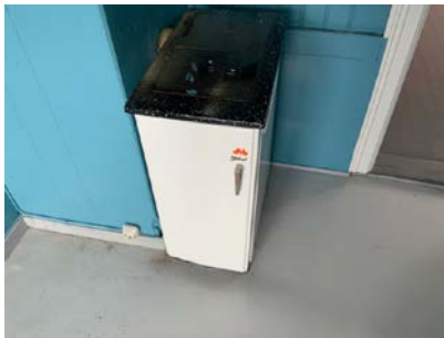
Mangler platte på gulv foran ovn og ovn er plassert for nær treverk og pipe
