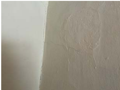
Sprekker og riss i pipe
