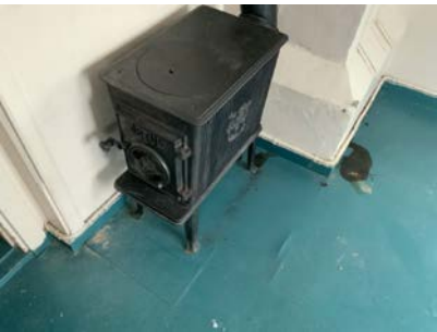
Mangler ildfast plate foran ovn
