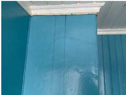
Rennemerker på pipe.
