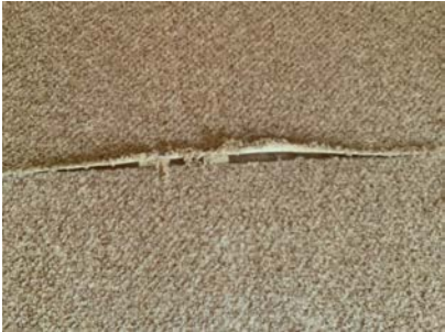
Vegg til vegg teppe løsner
