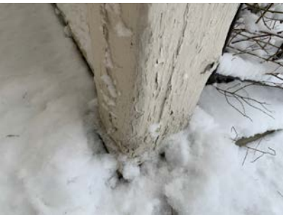
Råteskader i søyler.
