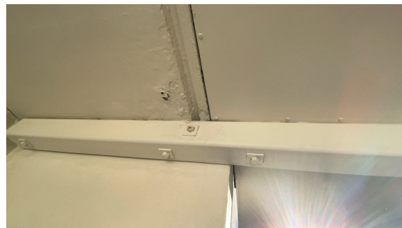
Avflassing i betong på overbygg på balkong
