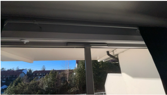
Spalteventil i vindu
