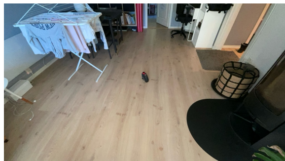
Skjevheter er registrert i stue
