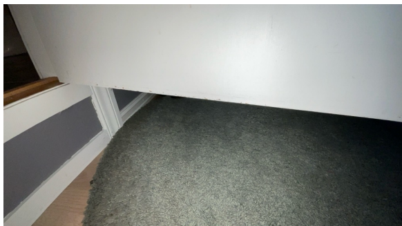
Fuktskader nederst på baderomsdøren
