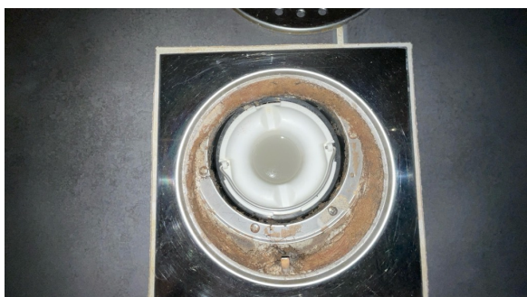
Sluk i dusjsone
