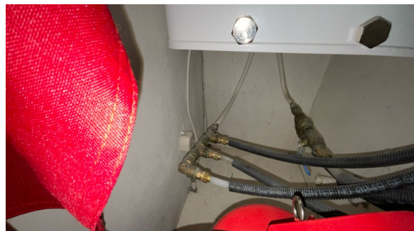
Tilkobling av bereder via stikkontakt tilfredstiller ikke dagens krav
