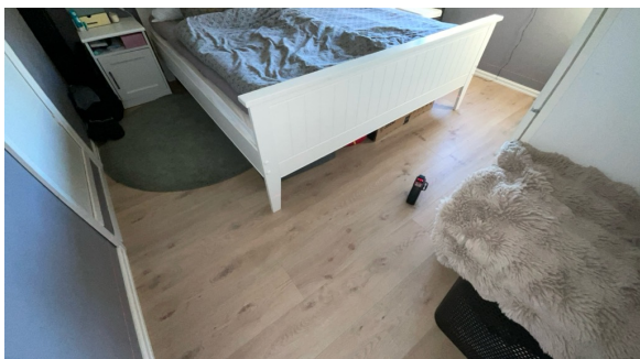
Skjevheter er registrert på hovedsoverom
