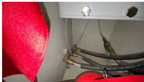
Tilkobling av bereder via stikkontakt tilfredstiller ikke dagens krav
