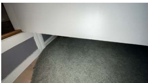
Fuktskader nederst på badersdøren
