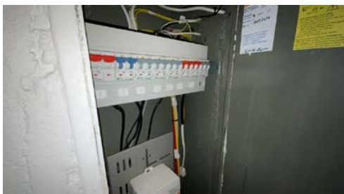
Sikringskap. Kursfortegnelse mangler.
