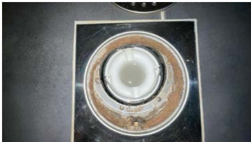
Sluk i dusjsone
