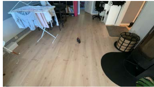
Skjevheter er registrert i stue
