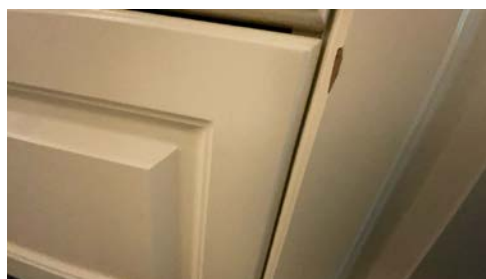
Skade på innredningen.
