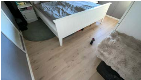
Skjevheter er registrert på hovedsoverom
