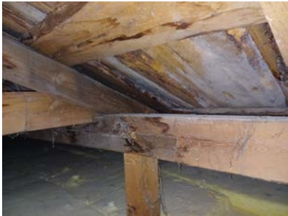
Bilde av fuktmerker på loft
