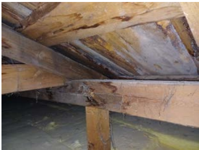
Bilde av fuktmerker på loft
