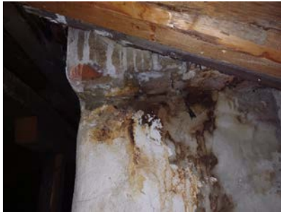
Bilde av fuktmerker på pipe
