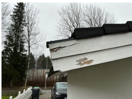
Råteskader i vindskier.
