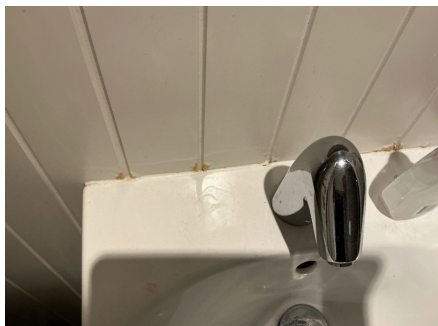
Svellinger i skjøtene på panelen.
