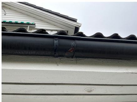
Rust og utettheter i takrenne.
