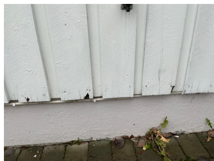
Råteskader nederst på panel.
