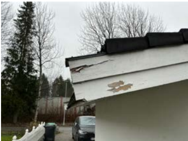
Råteskader i vindskier.
