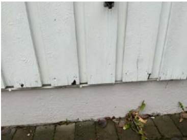
Råteskader nederst på panel.
