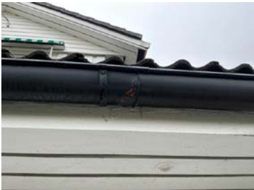
Rust og utettheter i takrenne.
