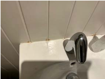
Svellinger i skjøtene på panelen.
