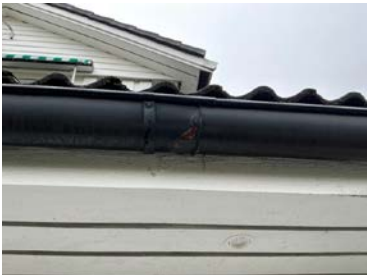
Rust og utettheter i takrenne.
