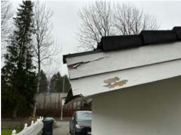
Råteskader i vindskier.
