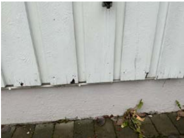
Råteskader nederst på panel.
