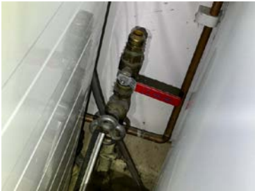
Korrosjon på koblingspunkter.
