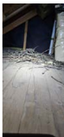
Rester etter et fuglereir i kneloft. Det har falt ned i luftehatten.
