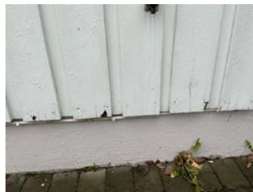
Råteskader nederst på panel.
