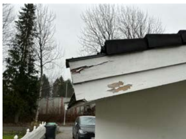
Råteskader i vindskier.
