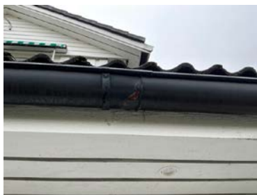
Rust og utettheter i takrenne.
