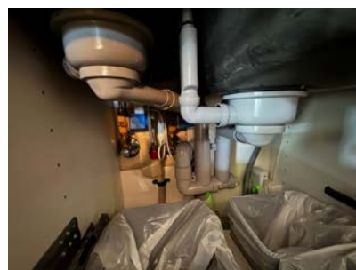
Innvendige avløpsrør i plast.
