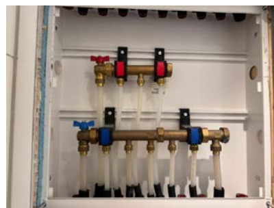
Fordelerskap for rør-i-rørsystem.
