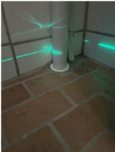
Manglende synlig membran rundt rørføringer gjennom gulv.
