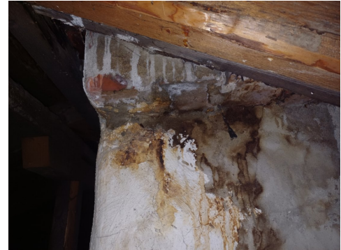
Bilde av fuktmerker på pipe
