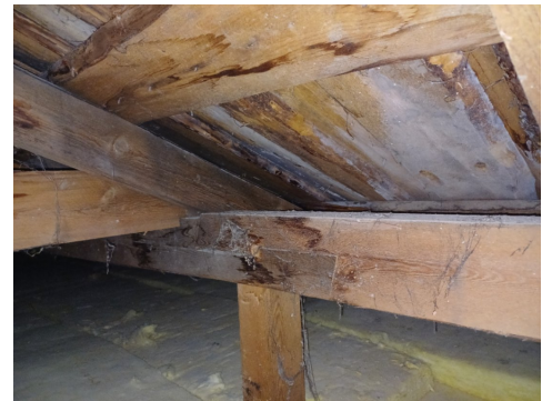
Bilde av fuktmerker på loft
