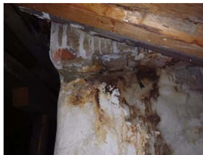
Bilde av fuktmerker på pipe
