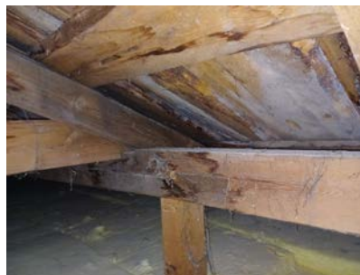
Bilde av fuktmerker på loft
