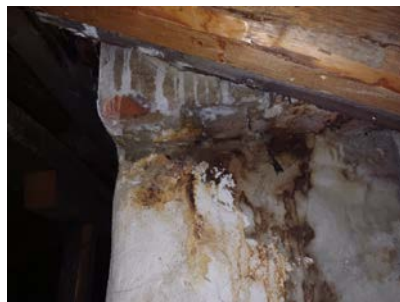
Bilde av fuktmerker på pipe
