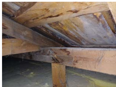
Bilde av fuktmerker på loft
