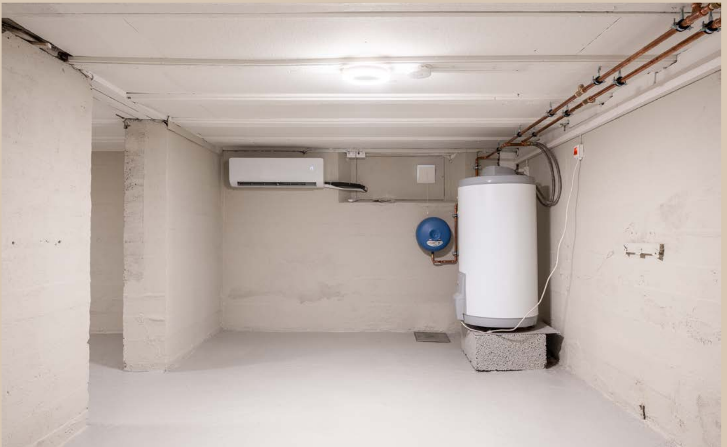
Kjelleren fikk ny varmepumpe i 2025 og nye klaffventiler for bedre ventilasjon.
