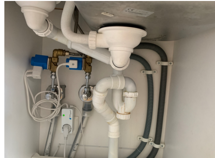
Røropplegget i kjøkken
