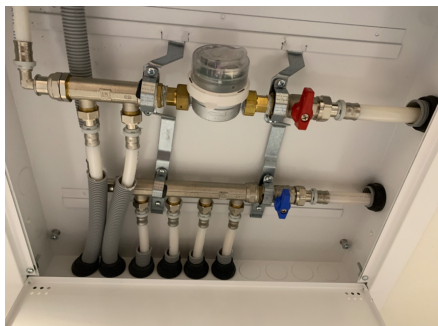
Rørskap plassert i gang
