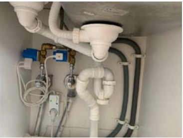
Røropplegget i kjøkken
