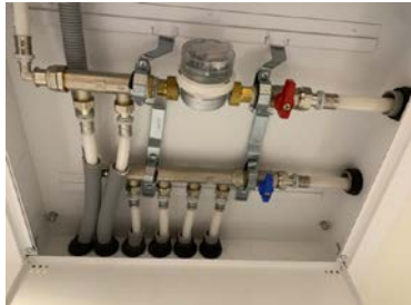
Rørskap plassert i gang
