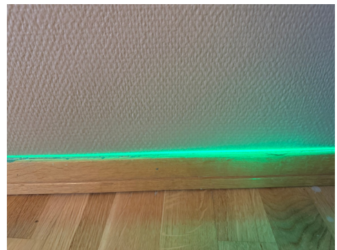
Bilder viser skjevheter i gulv på hovedsoverom.
