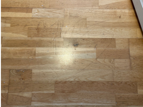
Slitasje/striper i parkettgulv.
