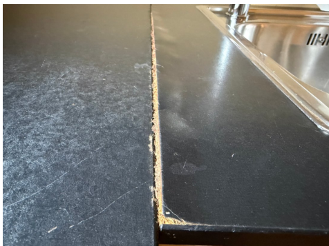
Fuktutsvelling i skjøt på benkeplate.
