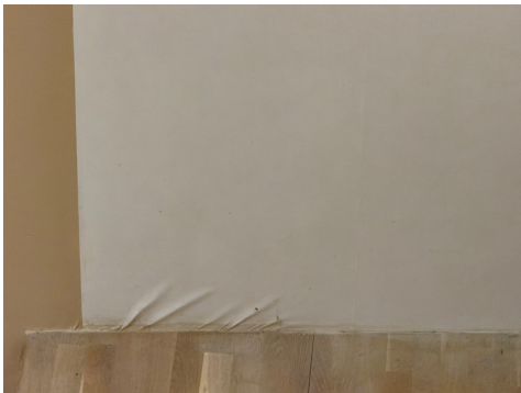
Ujevn veggoverflate i trapperom.
