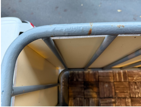
Rust på rekkverk.
