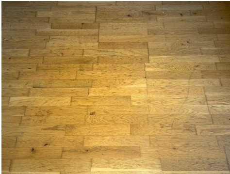
Slitasje/striper i parkettgulv.
