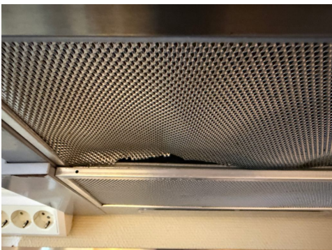
Bunker/skjevheter i rist i ytre del av ventilator.
