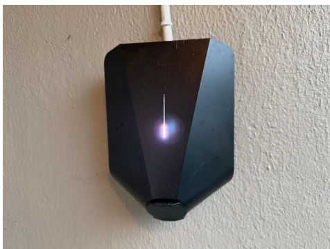
El. bil ladestasjon v/ biloppstillingsplass.
