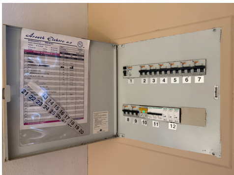
Sikringsskap i trapperom i 1-etg.
