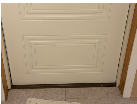
Slitasje i nedre del av ytterdør.
