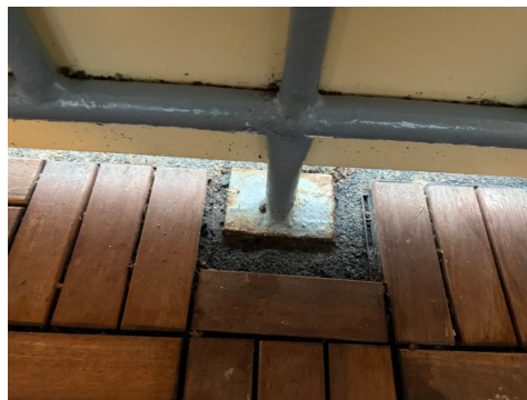
Rust på rekkverk.
