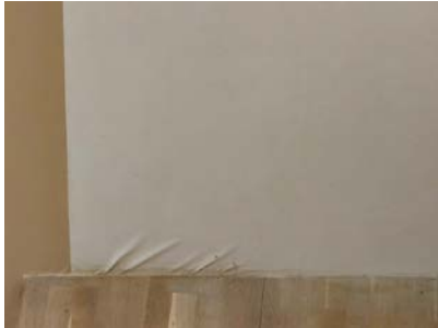
Ujevn veggoverflate i trapperom.
