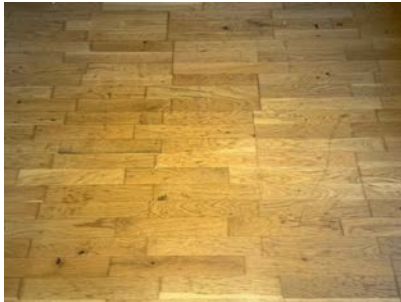
Slitasje/striper i parkettgulv.
