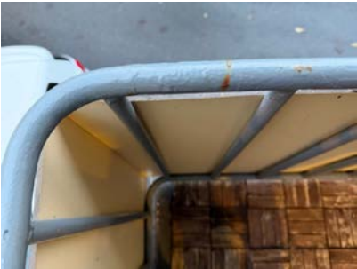
Rust på rekkverk.
