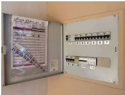
Sikringsskap i trapperom i 1-etg.
