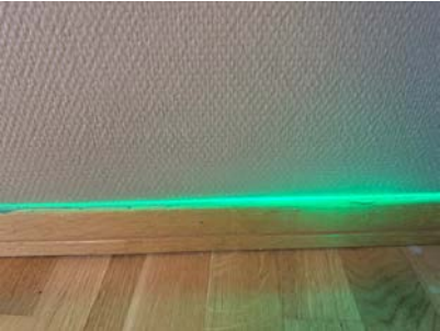
Bilder viser skjevheter i gulv på hovedsoverom.
