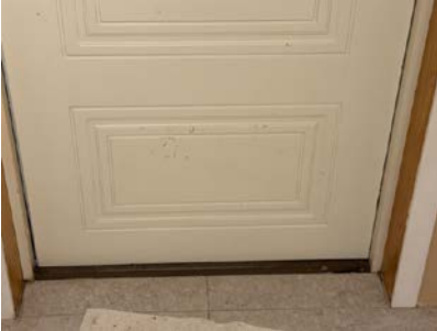
Slitasje i nedre del av ytterdør.
