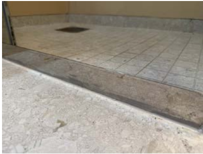
Det er oppkant inntil dusjsone. Dersom det oppstår en lekkasje utenfor dusjsone vil ikke lekkasjevann ledes til sluk.
