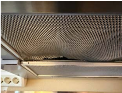
Bunker/skjevheter i rist i ytre del av ventilator.
