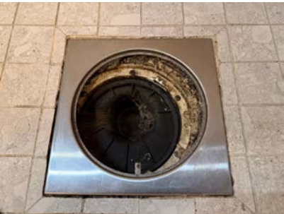
Plastsluk i dusjsone.
