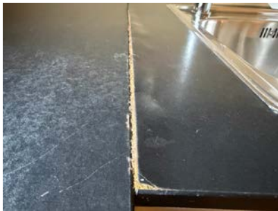
Fuktutsvelling i skjøt på benkeplate.
