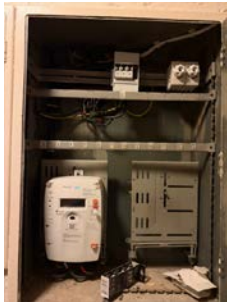
Hovedsikring og strømmåler i fellesarealer. Skrusikring tilhører ikke leiligheten.
