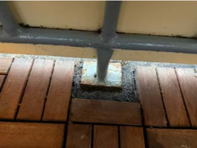
Rust på rekkverk.
