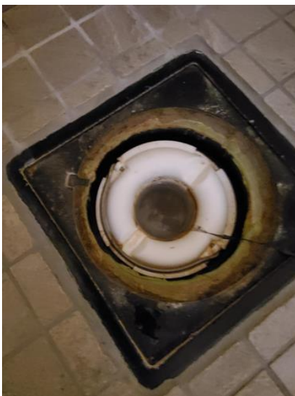
Helhetsvurdering - [Sluk bad 1.etasje hovedbygning ]
