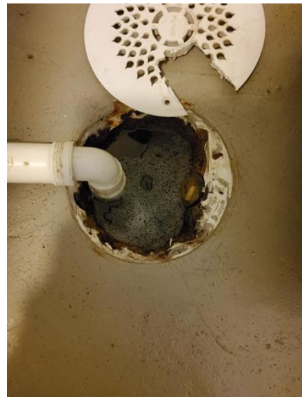
Helhetsvurdering - [Sluk bad 1.etasje sidebygning ]
