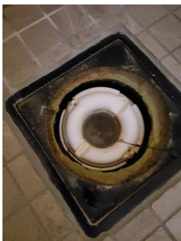
Helhetsvurdering - [Sluk bad 1.etasje hovedbygning ]
