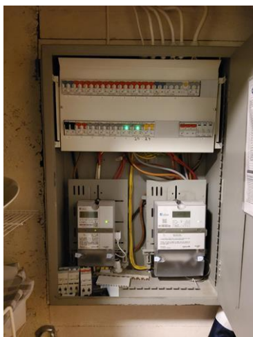
Elektrisk anlegg - [Sikringskap sidebygning ]
