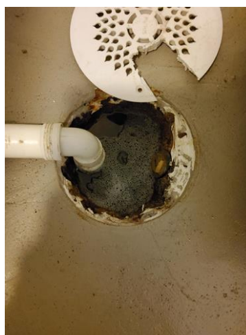
Helhetsvurdering - [Sluk bad 1.etasje sidebygning ]
