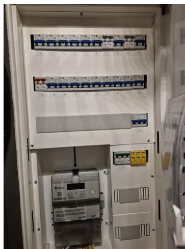
Elektrisk anlegg - [Sikringskap hovedbygning ]
