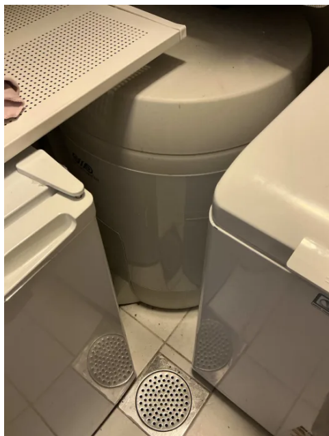
Varmtvannsbereder på bod.
