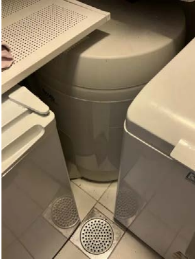
Varmtvannsbereder på bod.
