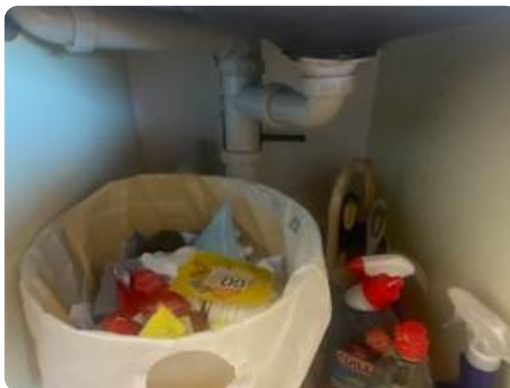
Avløpsrør under kjøkkenbenk
