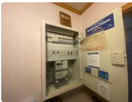
Underfordeling/sikringsskap i rekkehus
