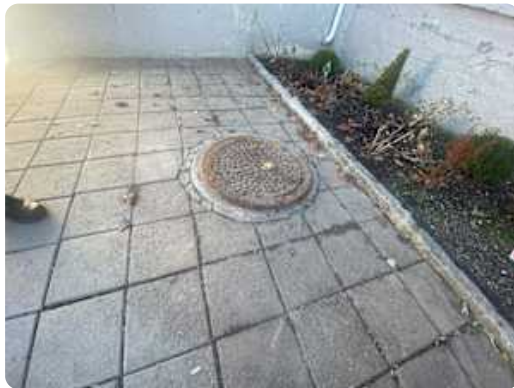
Utendig hovedstoppekran plassert i kum
