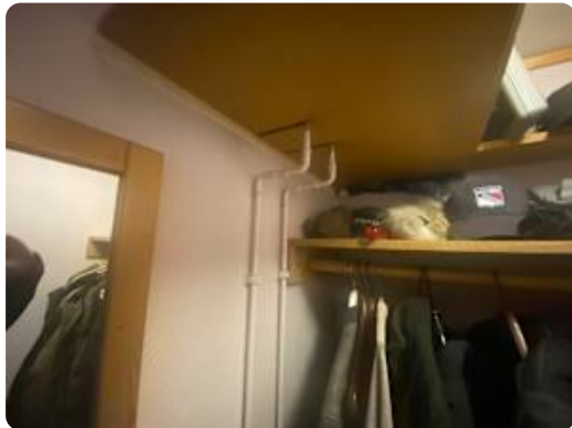
Varmerør i rekkehus
