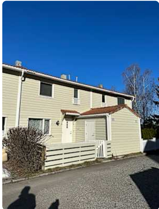
Plateledning på rekkehusene
