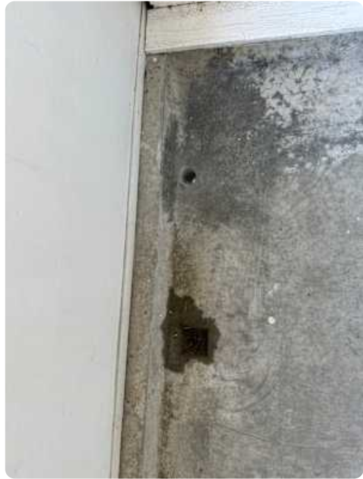
Avrenning i balkongdekke
