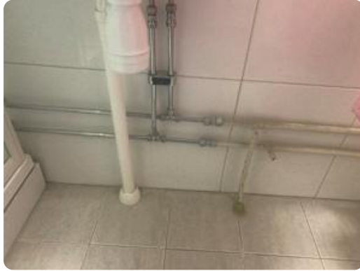
Rør på badrom
