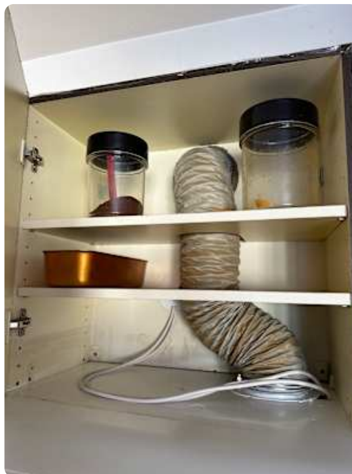
Kanal til ventilator
