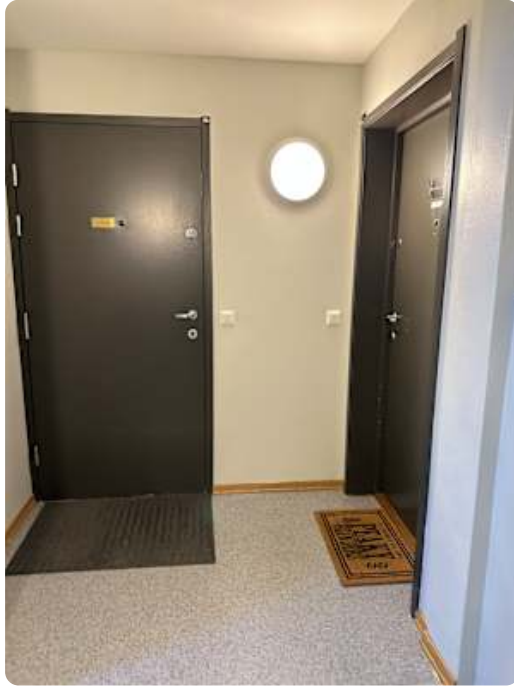
Belyningsutstyr i fellesareal
