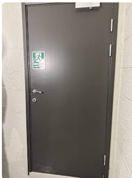
Brannør til loft
