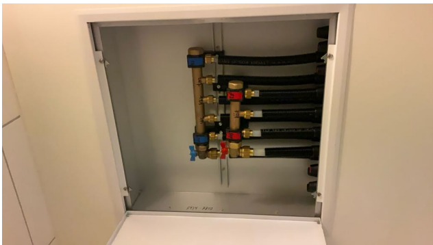
Rørskap i himling.
