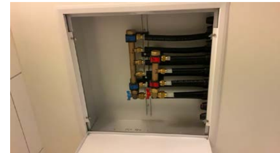
Rørskap i himling.
