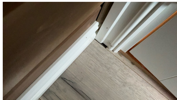
Unøyaktig avslutning mellom gulv og dør/list
