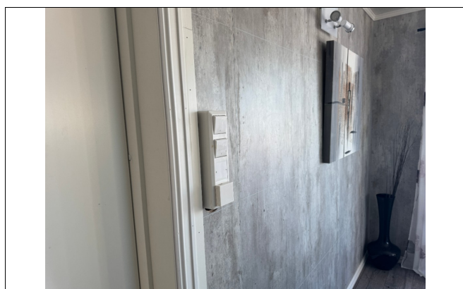
Garasje/velværerom: Unøyaktig utskjæring for elektrikerboks
