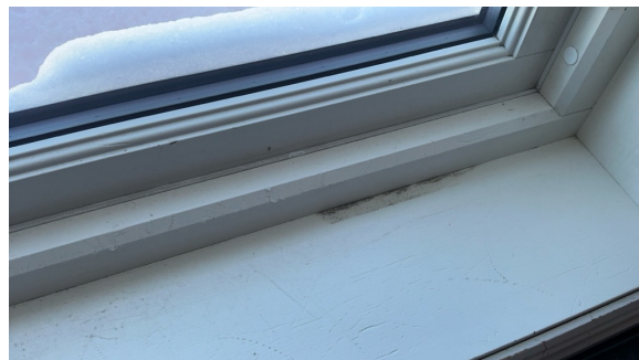
Slitasje i utforinger
