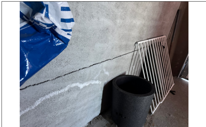
Garasje/velværom: Sprekk i grunnmur
