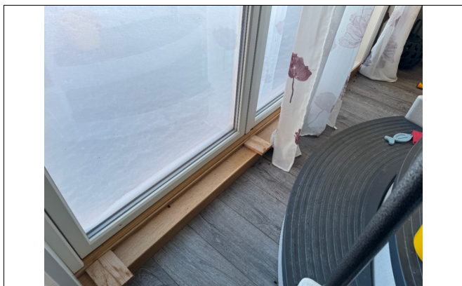
Garasje/velværom: Uferdige arbeider rundt terrassedør i velværom
