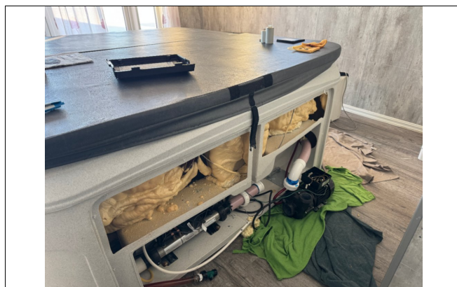
Garasje/velværom: Boblebad inne i garasje der pumpe skal skiftes ut før salg iht opplyst av eier
