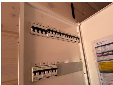
Sikringer i sikringsskap
