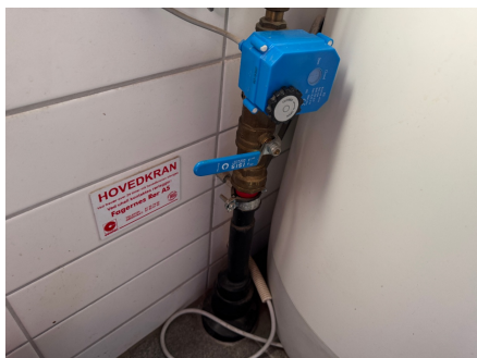
Stoppekran montert på teknisk bod
