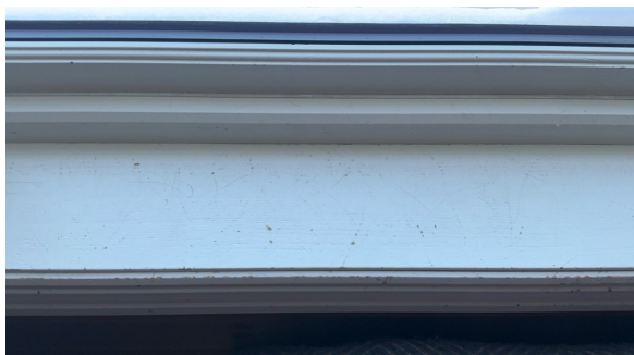
Slitasje i utforinger
