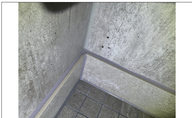
Garasje/velværerom: Ufagmessig overgang mellom baderomsplate og fliser
