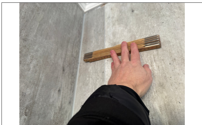
Garasje/velværom: Ujevnheter i overflater av baderomsplater på velværom
