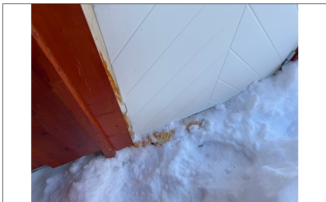
Garasje/velværerom: Ikke montert beslag under dør og ikke skjært bort overskudd av byggeskum rundt dør
