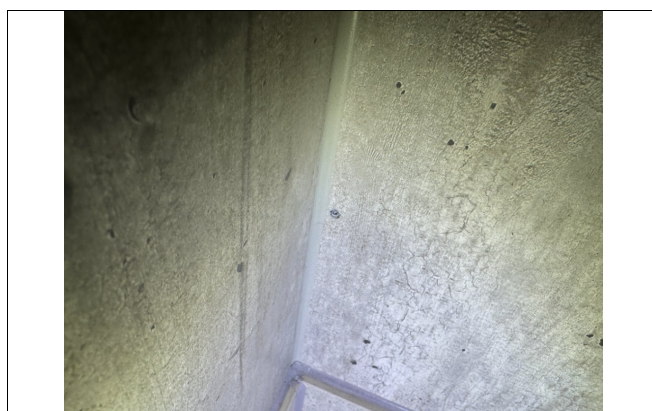
Garasje/velværom: Skrue skrudd gjennom plate i dusjsone - Dette medfører at det må påregnes utetthet i plate.
