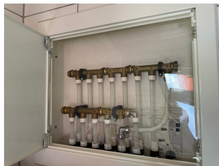
Vannskap montert på teknisk bod
