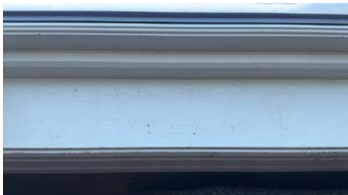
Slitasje i utforinger
