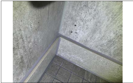
Garasje/velværerom: Ufagmessig overgang mellom baderomsplate og fliser
