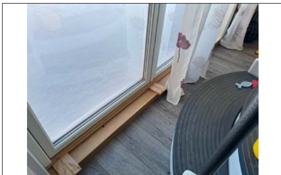
Garasje/velværerom: Uferdige arbeider rundt terrassedør i velværerom
