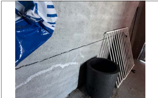
Garasje/velværerom: Sprekk i grunnmur
