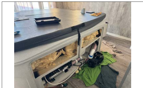
Garasje/velværerom: Boblebad inne i garasje der pumpe skal skiftes ut før salg iht opplyst av eier
