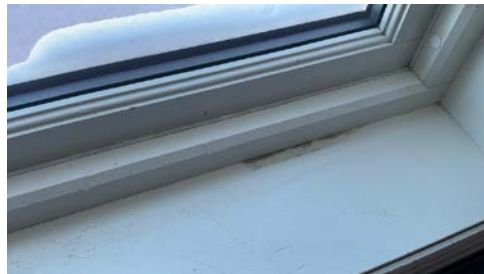
Slitasje i utforinger
