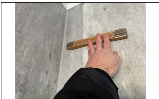
Garasje/velværerom: Ujevnheter i overflater av baderomsplater på velværerom
