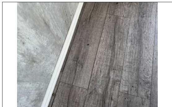
Garasje/velværerom: Overgang mellom gulv og baderomsplater i velværerom.
