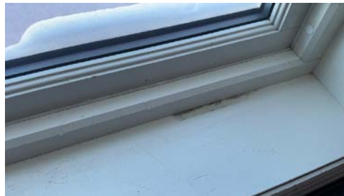
Slitasje i utforinger
