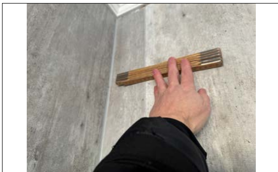
Garasje/velværerom: Ujevnheter i overflater av baderomsplater på velværerom
