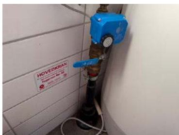
Stoppekran montert på teknisk bod
