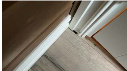
Unøyaktig avslutning mellom gulv og dør/list
