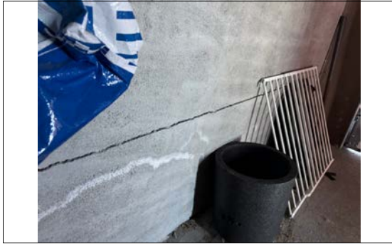
Garasje/velværerom: Sprekk i grunnmur
