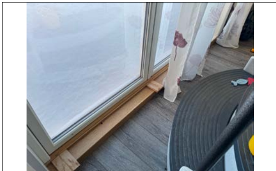
Garasje/velværerom: Uferdige arbeider rundt terrassedør i velværerom
