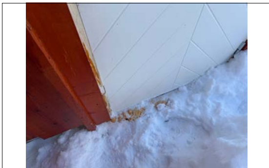
Garasje/velværerom: Ikke montert beslag under dør og ikke skjært bort overskudd av byggeskum rundt dør
