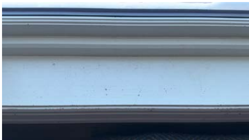
Slitasje i utforinger
