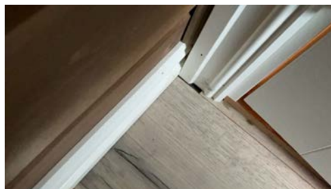
Unøyaktig avslutning mellom gulv og dør/list
