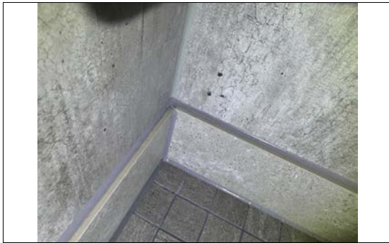
Garasje/velværerom: Ufagmessig overgang mellom baderomsplate og fliser
