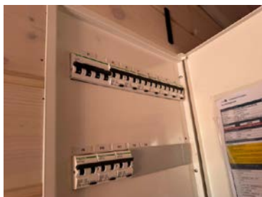
Sikringer i sikringsskap
