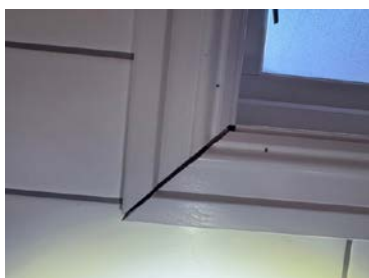
Unøyaktig utførelse av lister rundt vindu på bad
