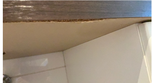
Svelling under benkeplate.
